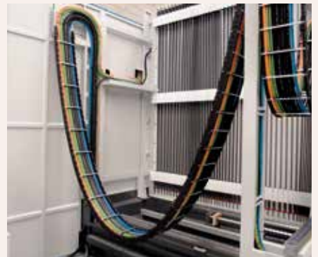
■ Affidabilità grazie ad una corretta impiantistica. Reliability thanks to a well done plant design.
